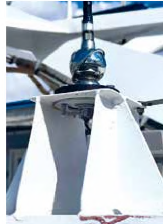
Рис.6 Избыточный фундамент антенны. Конструкция была не согласована.
